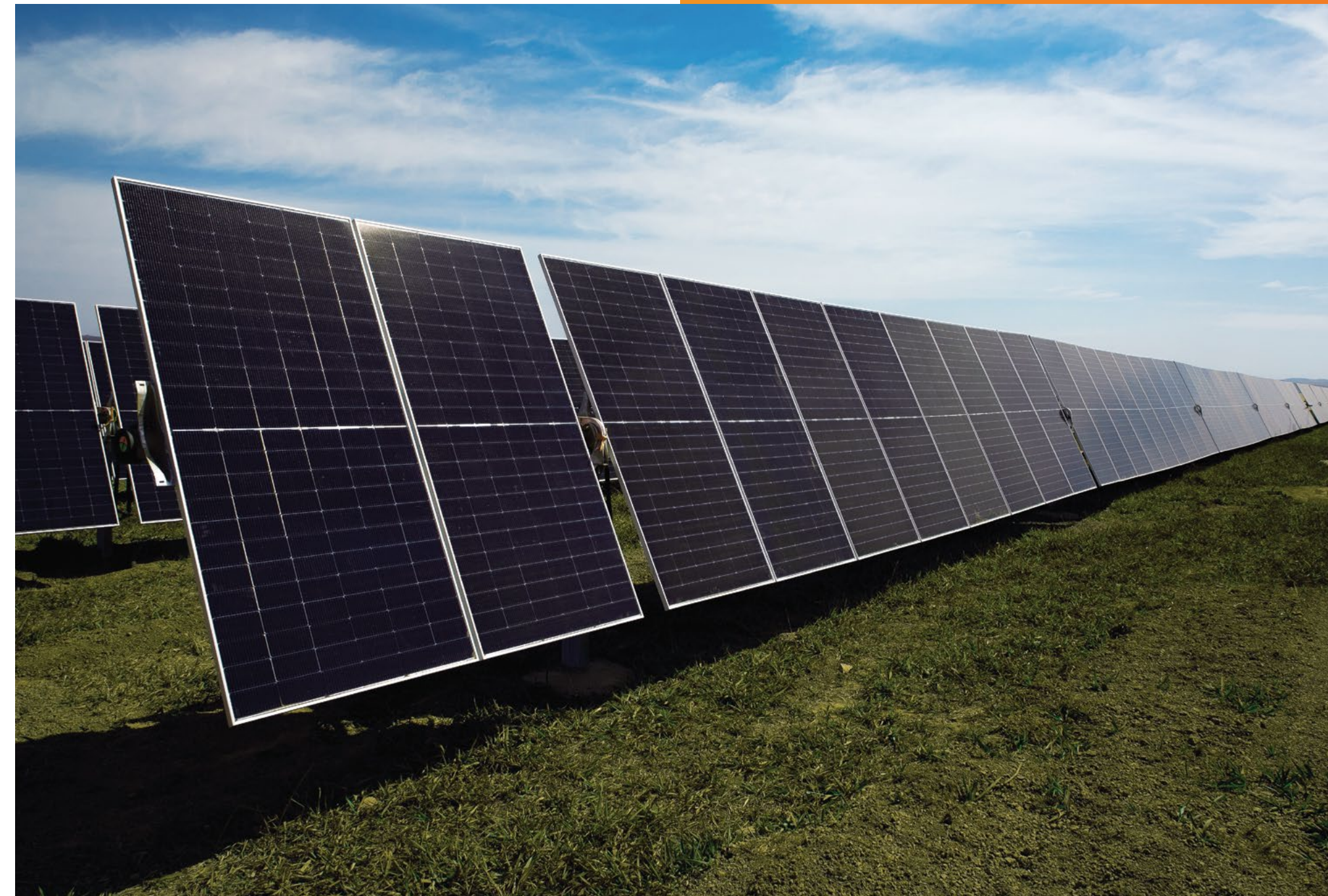
Painéis fotovoltaicos do Complexo Solar Boa Sorte
